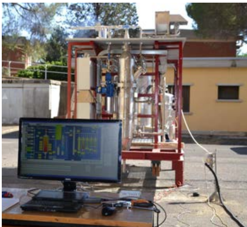
Figura 8. Sperimentazione sull'impianto GESSYCA
