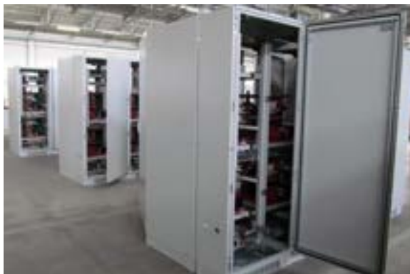
Raffreddamento dei semiconduttori con acqua demineralizzata.
