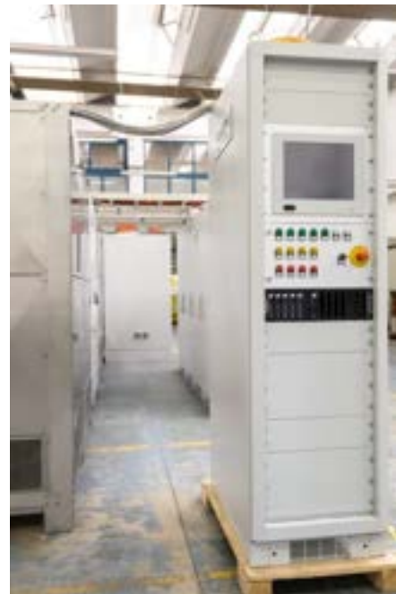
Local Control cubicle della SNU
