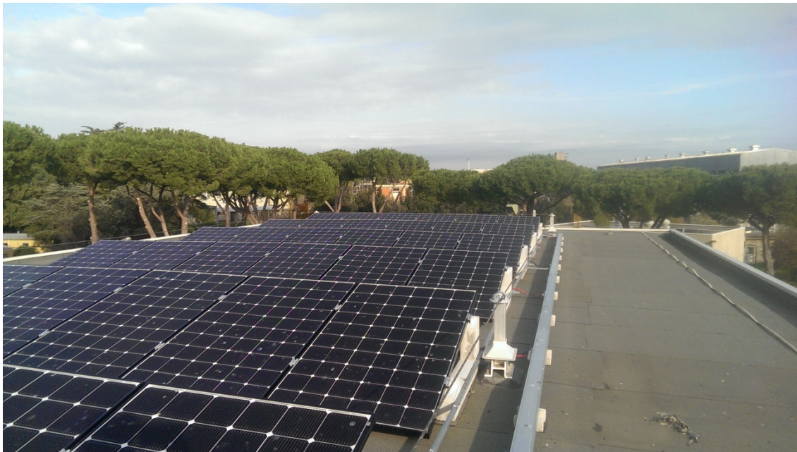
Figura 20. Il Generatore fotovoltaico
