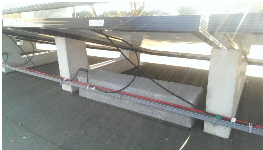
Figura 22. Particolare della struttura di sostegno dei moduli
