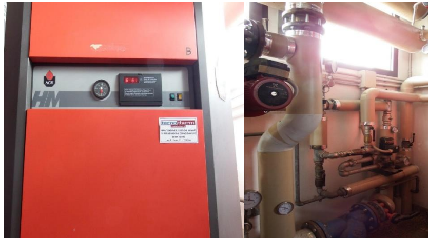
Figura 3-4 A sinistra foto della caldaia ACV, a destra foto del disgiuntore
