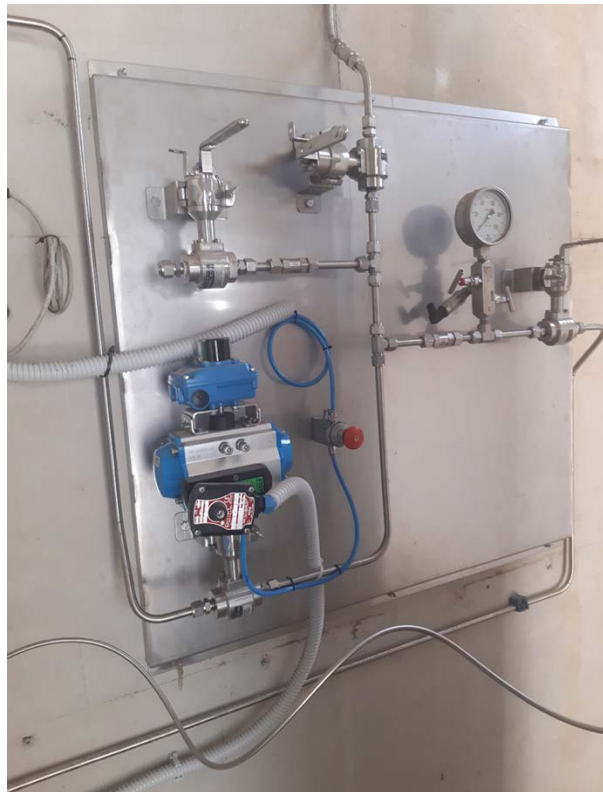
Figura 5.33. Centrale di riduzione della pressione dell'idrogeno.
