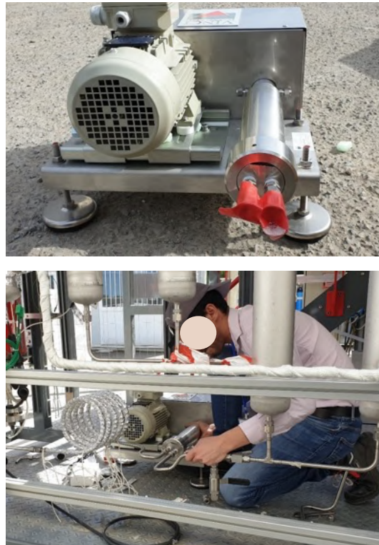
Figura 5.24. Pompa dell'olio (in alto) e installazione dell'intero circuito dell'olio diatermico (in basso).
