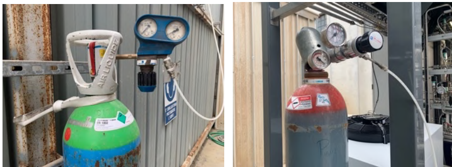
Figura 5.30. Bombe di aria e idrogeno per il funzionamento del gas-cromatografo, posizionate nei pressi dell'impianto.
