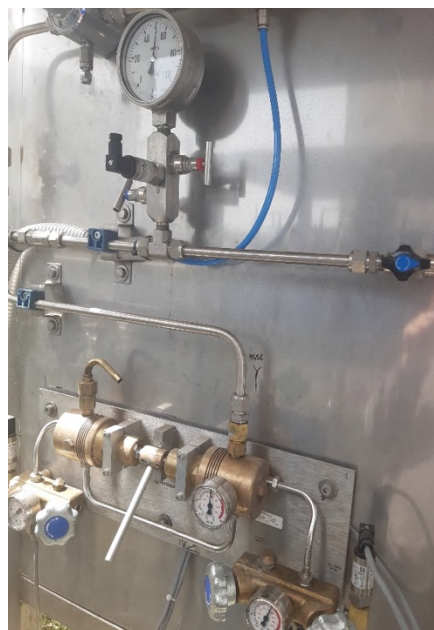
Figura 5.37. Centrale di riduzione della pressione dell'azoto.
