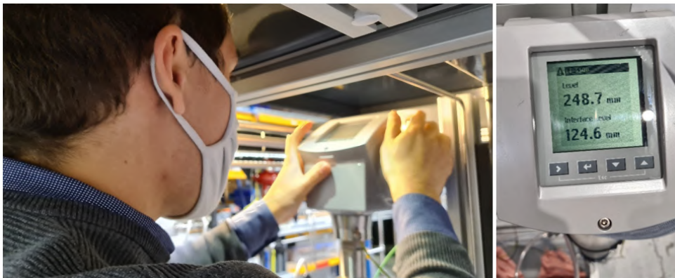
Figura 5.9. Calibrazione del livello nel separatore LP da parte dell'operatore (sinistra) e rilevamento dell'altezza di livello tramite il trasmettitore LT-3300 (destra).
