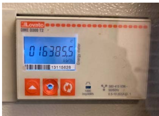
Figura 2.23. Contatore di energia Lovato Electric DME D300 T2.
