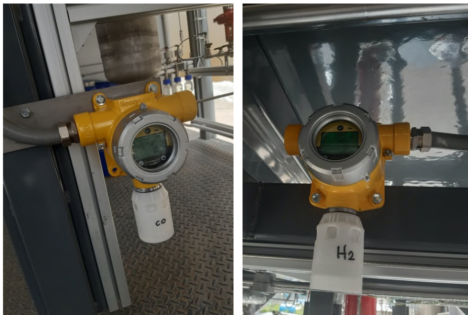
Figura 5.38. Rilevatori gas (CO e H 2 ).
