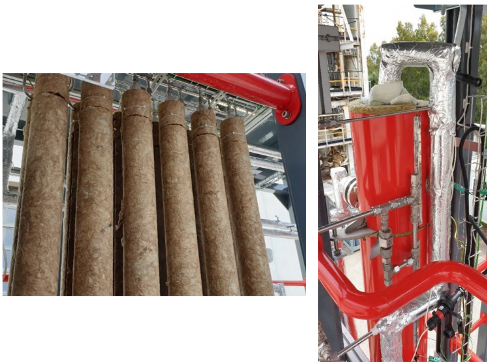
Figura 5.20. Primo strato di rivestimento termico per i 12 tubi costituenti il reattore multitubolare (sinistra) e coibentazione finale del reattore monotubolare (destra).
