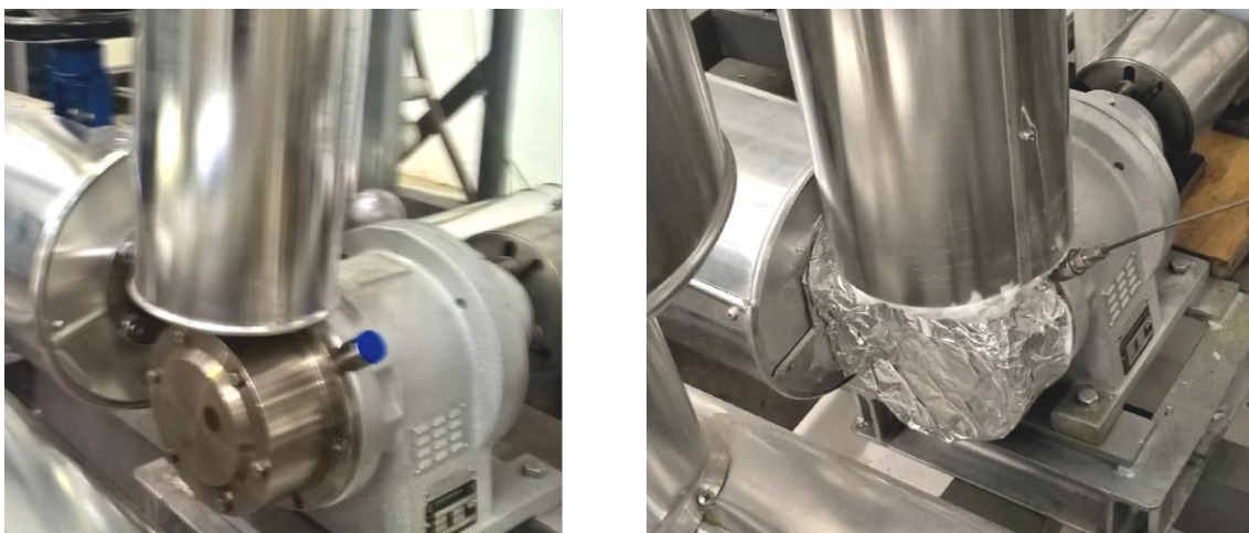
Figura 2-8: Coibentazione girante pompa di circolazione.
