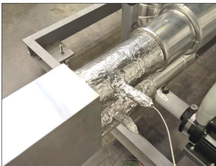
Figura 2-10: Coibentazione stelo termocoppia. Sostituzione pompa a trascinamento magnetico
