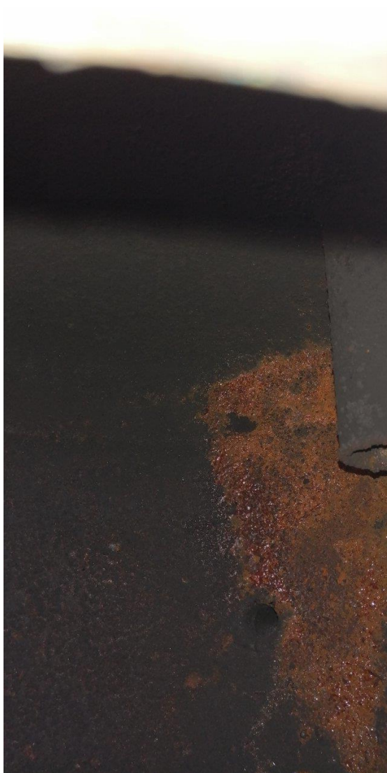
Figura 2-14: particolari che mostrano l'interno del vecchio serbatoio, chiaramente danneggiato.
