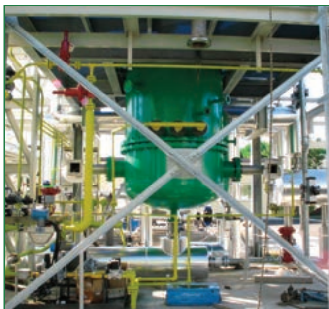
Reattore di decarbonatazione: adduzione gas di processo
