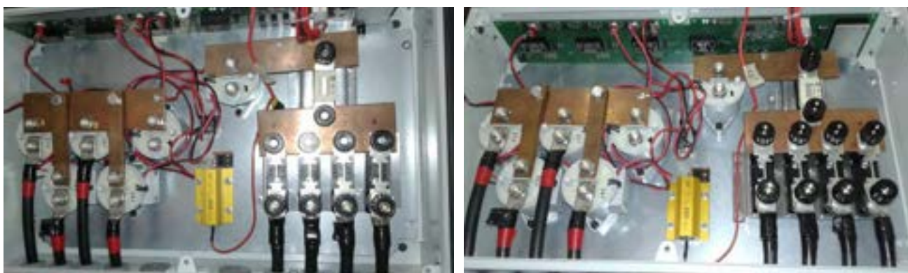
Figura 22. Vista interna della scatola elettronica di controllo
