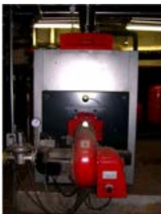
Figura 11: Caldaia Viessmann Vitocrossal 300 tipo CR3
