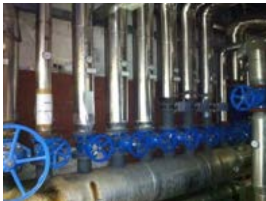
Figura 20: Collettore di mandata dell'impianto
