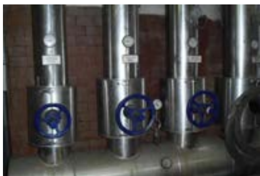
Figura 25: Collettore circuito palazzina uffici
