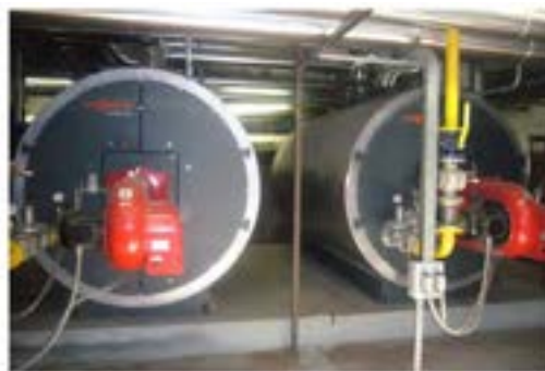
Figura 13: Caldaie Vitomax 200 tipo M241
