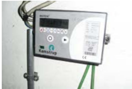
Figura 28: Misuratore di calore nr.9
