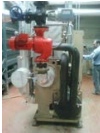
Figura 16: Gruppo frigorifero a compressione TRANE RTWB 214
