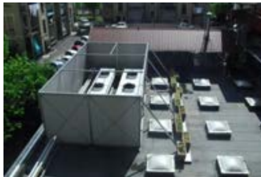
Figura 29: Dissipatore aerotermo del cogeneratore
