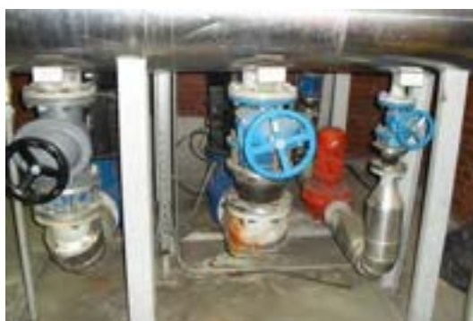
Figura 27: Pompe del circuito di teleriscaldamento
