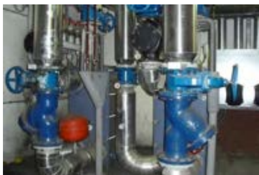
Figura 26: Scambiatori di calore lato circuito di teleriscaldamento
