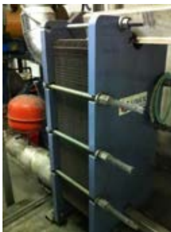
Figura 22: Scambiatore di calore lato circuito palazzina uffici
