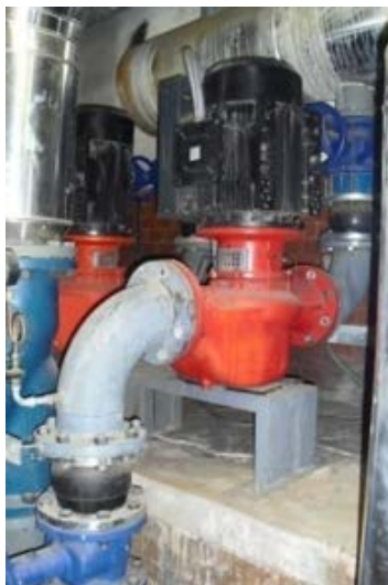
Figura 21: Pompe sul collettore di mandata
