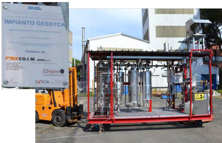
Figura 15. Targa di impianto e dettaglio
