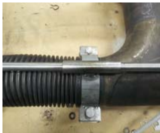
Figura 10. Particolare del sistema di irrigidimento del cross-piping dopo la riconfigurazione.
