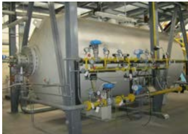
Figura 5. Vessel. Vista lato combustore e rampa gas.
