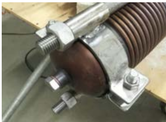
Figura 9. Particolare dei tiranti di irrigidimento e della tenuta lato fondello del cross-piping dopo la riconfigurazione.
