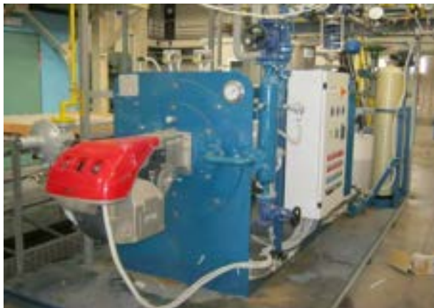
Figura 4. Generatore di vapore.
