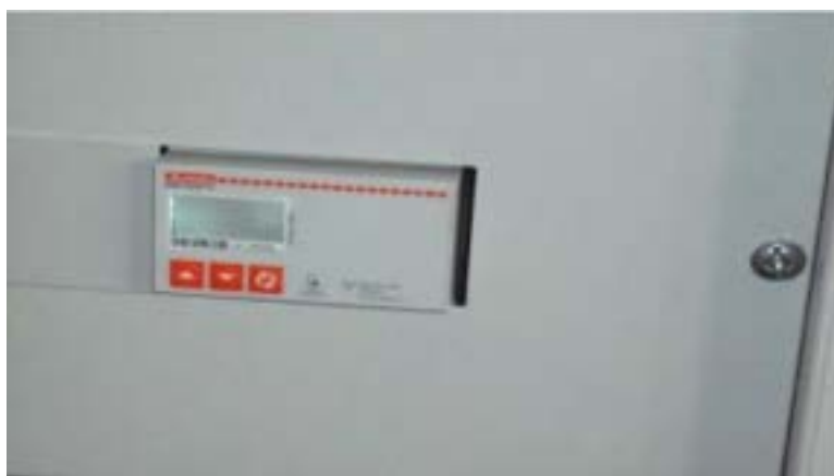
Figura 15 Contatore elettrico per il sistema di rigenerazione ammine.
