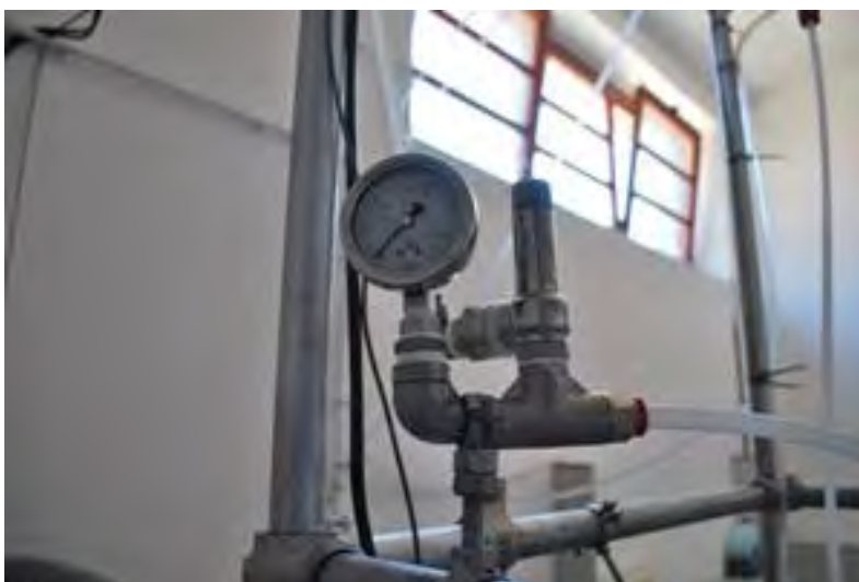
Figura 15-13. Manometro e valvola di sicurezza.
