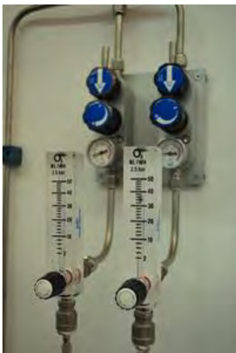
Figura 15-5. Sistema di regolazione finale della pressione e della portata della miscela gassosa.
