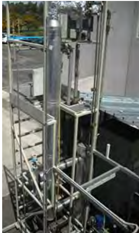
Figura 5-4 Unità di rigenerazione ammine dell'impianto Sotacarbo.
