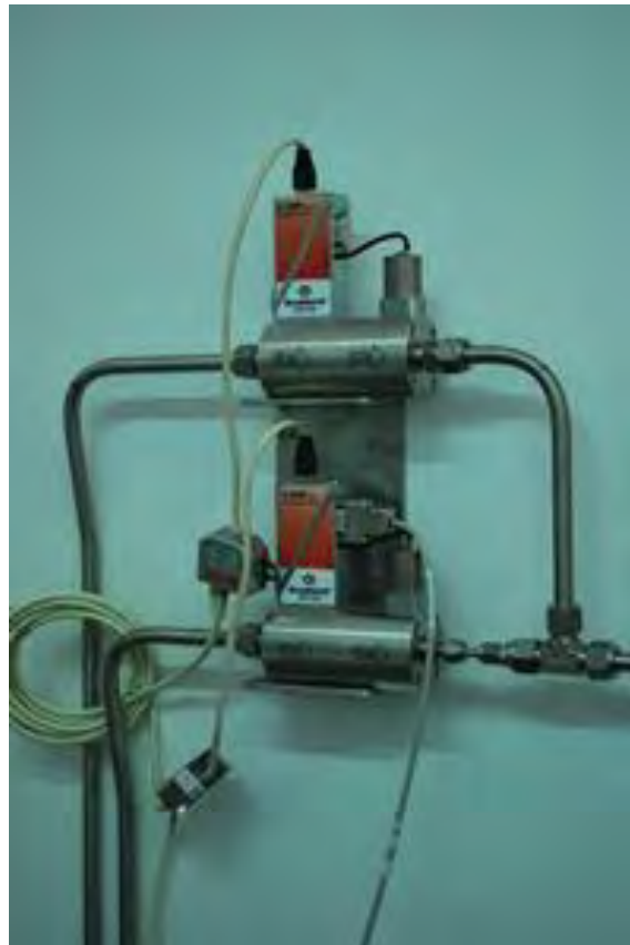
Figura 15-7 Particolare del sistema di miscelazione con regolatori massici di portata.
