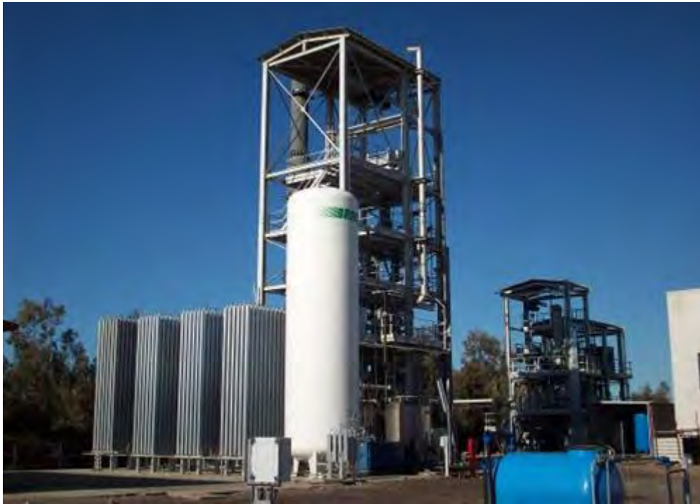
Figura 1.1 - La piattaforma pilota Sotacarbo
