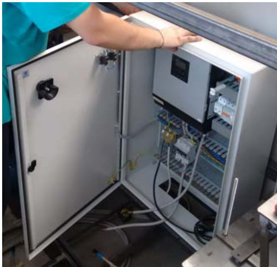
Figura 25 – Il quadro di potenza con l'inverter e gli alimentatori.
