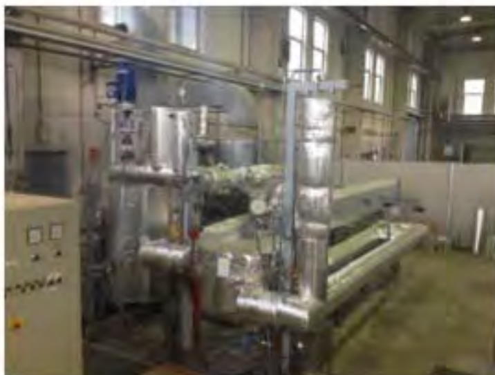
Figura 2. - impianto MOSE (ENEA).
