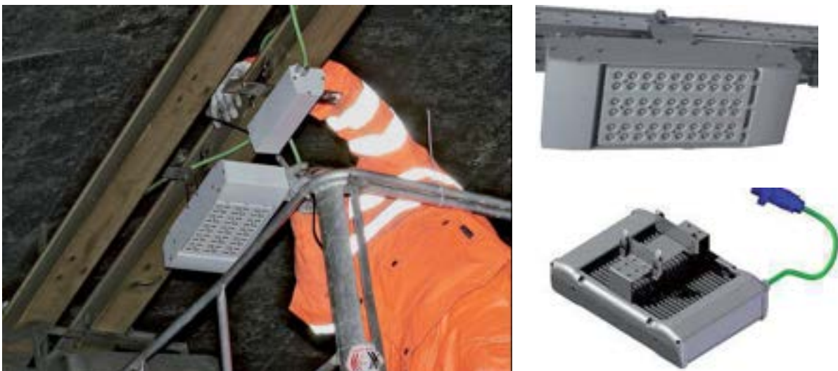
Figura A1.12. L'apparecchio LED Ledway Tunnel, impiegato nella galleria Crocina e nella galleria Vado.
