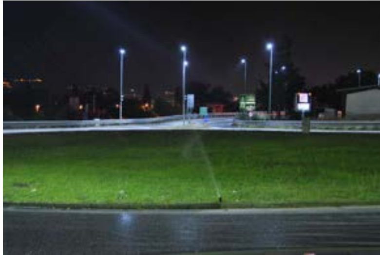
Fig. 5.17 - Risultato dell'illuminazione a LED dello svincolo per Cosenza sull'autostrada Salerno – Reggio Calabria (EIAESCO S.r.l.)
