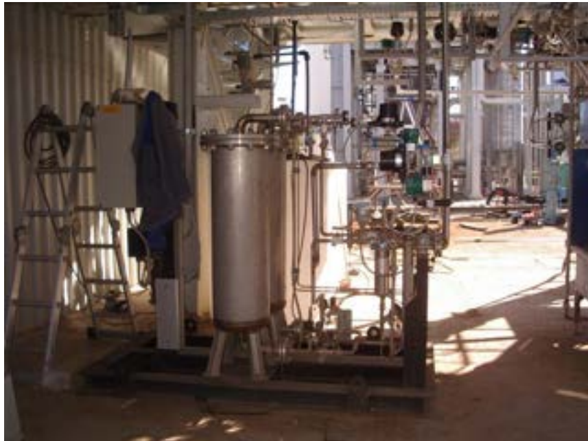
Figura 1.7. Il sistema PSA per la purificazione dell'idrogeno.
