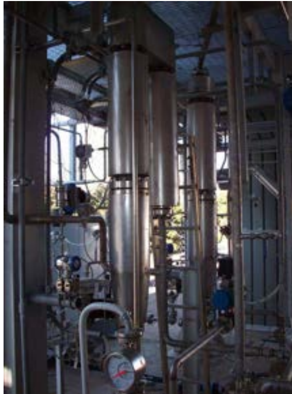
Figura 1.5. Reattori di CO-shift ad alta e bassa temperatura.
