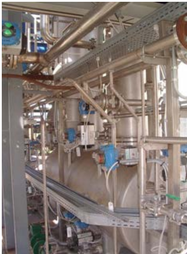
Figura 1.1. Skid di trattamento a freddo del syngas.
