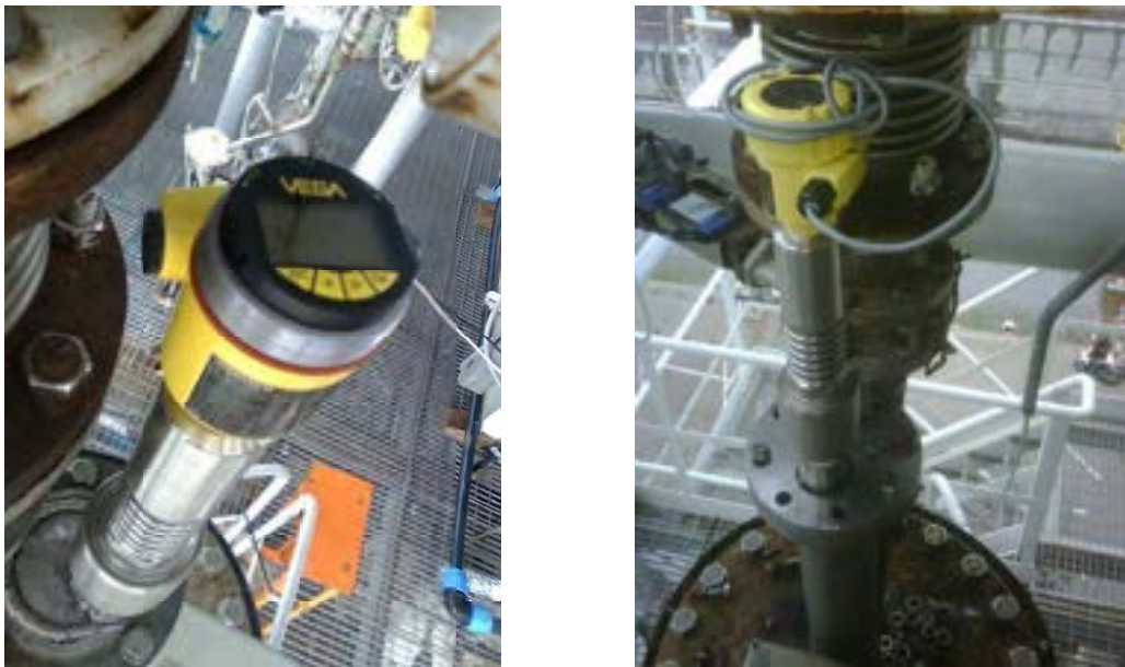
Figura 16 - Vista di dettaglio del misuratore di livello carbone.
