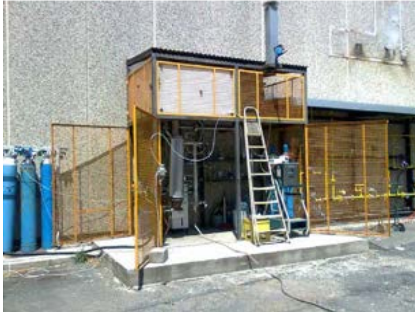
Figura 1: Mini impianto di gassificazione GESSICA
