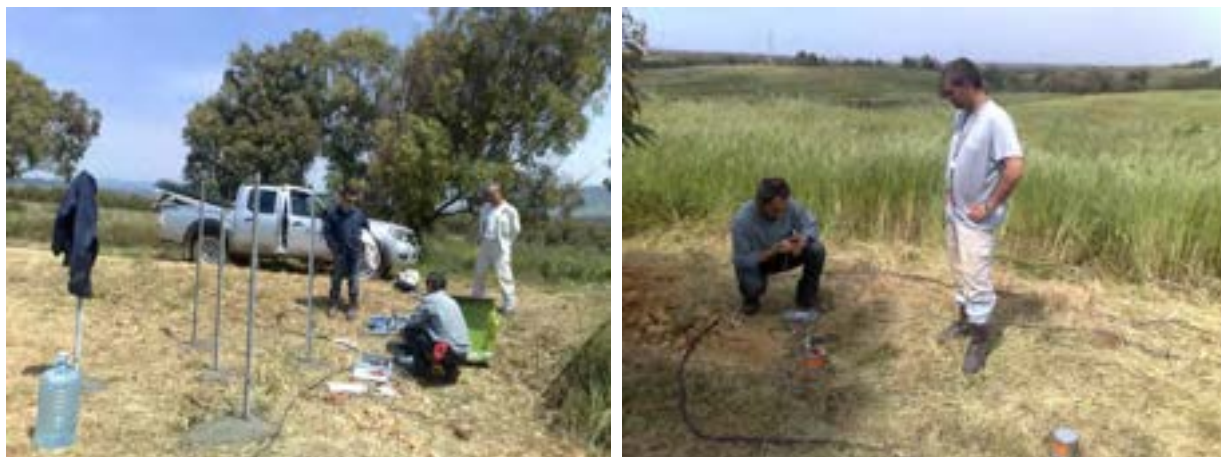
Figura 12. Primo intervento di installazione del sistema di monitoraggio 1 avvenuto in data 29 aprile 2011.
