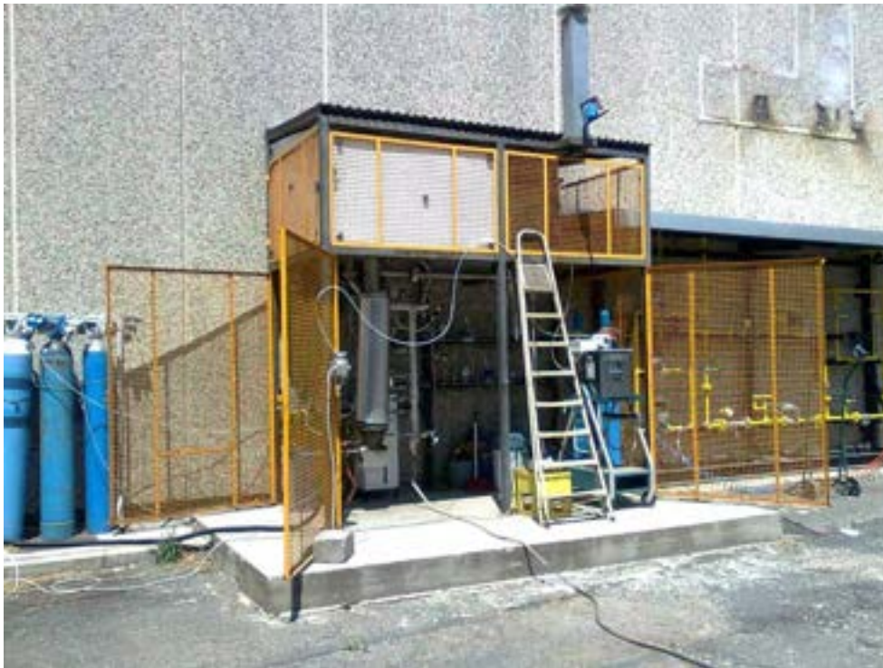
Fig. 1: Mini impianto di gassificazione GESSICA
