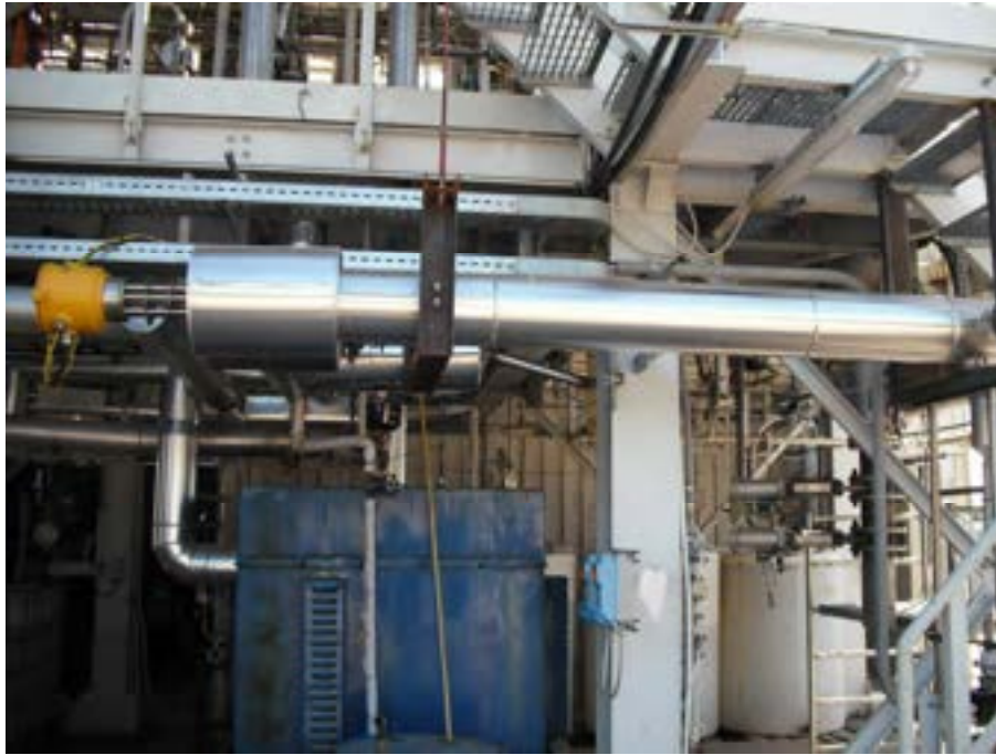
Figura 2.8.2 . coibentazione del riscaldatore degli agenti gassificanti
