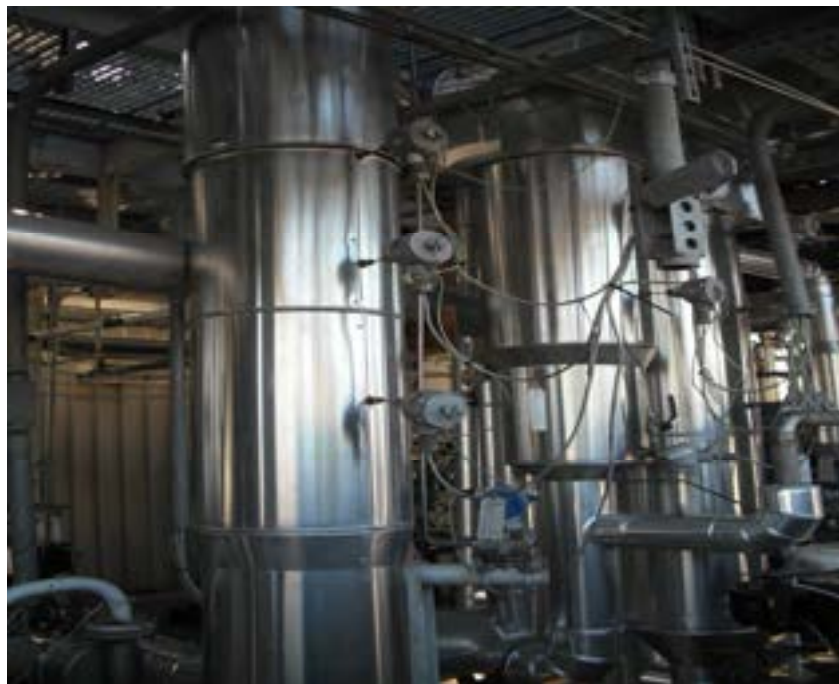
Figura 2.8.1 . coibentazione reattori di CO-Shift
