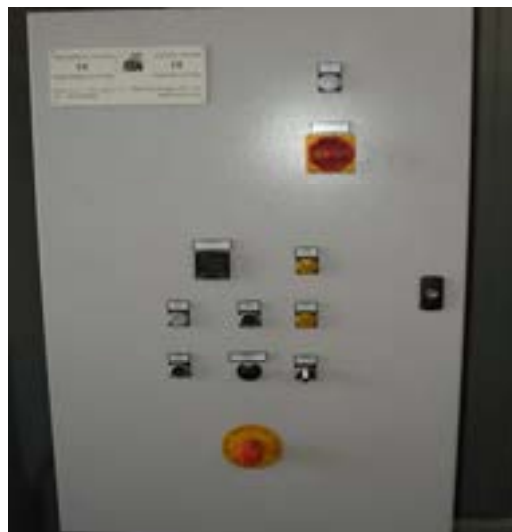
Figura 2.2.2 .quadro di regolazione e controllo surriscaldatore elettrico
