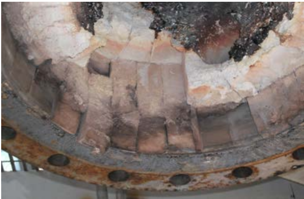
Figura 2.3.3 .refrattario lesionato da sostituire
