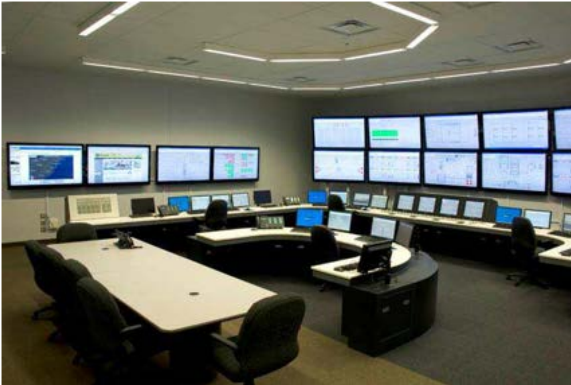
Fig. 2-1 Simulatore Westinghouse di sala controllo dell'impianto AP1000
