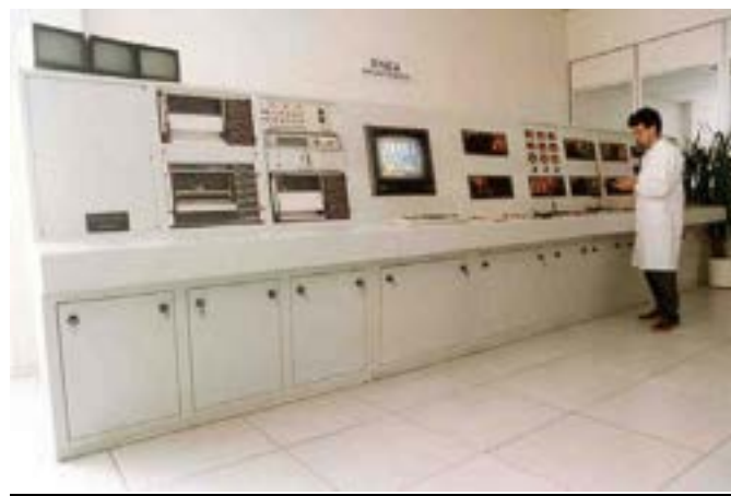
Fig.C1-8 Sala Controllo Impianto SPES
