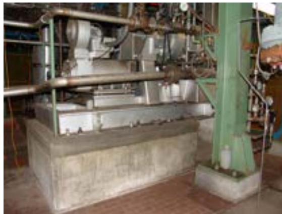
Fig.C1-6 Pompa Primaria Impianto SPES-2
