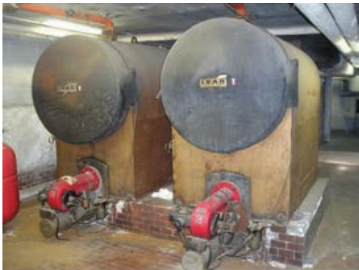
Fig. 18. Caldaie a gas
