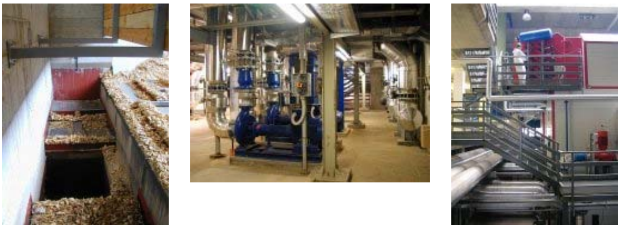
Figura 24 - Particolari della centrale. (Fonte: http://www.teleriscaldamento.valtline.it/tirano/ ).
