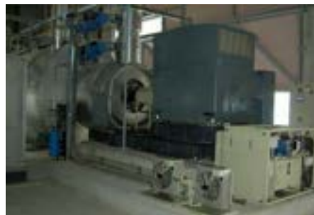
Figura 33 - Generatore elettrico. (Fonte: www.fti.bz/it/informazioni/impianto.html ).
