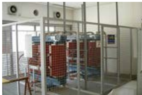
Figura 32 - Stazione di trasformazione. (Fonte: www.fti.bz/it/informazioni/impianto.html ).
