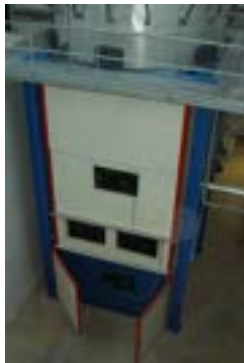
Figura 30 - Caldaia 10 MW. (Fonte: www.fti.bz/it/informazioni/impianto.html ).
