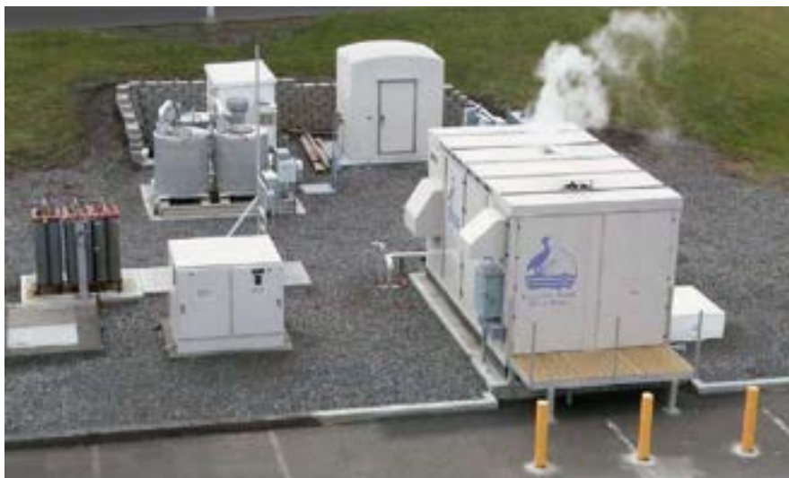
Figura 77 - L'impianto di celle a combustibile da 200 kW. (Fonte: www.eere.energy.gov ).
