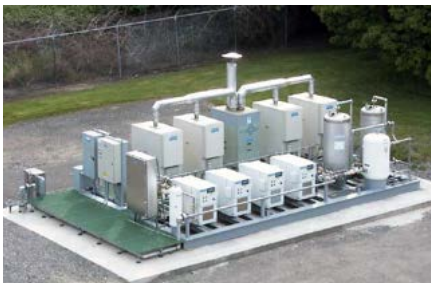
Figura 78 - L'impianto di microturbine. Si tratta di 4 turbine Capstone da 30 kW con centrale di recupero del calore.
