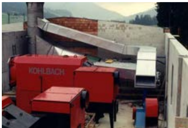
Figura 26 - Immagine dell'installazione della caldaia 1995. (Fonte: http://www.fti.bz/it/informazioni/impianto.html ).
