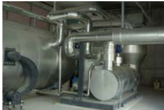
Figura 31 - Modulo ORC. (Fonte: www.fti.bz/it/informazioni/impianto.html ).
