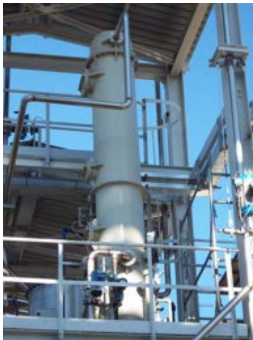
Figura 2.3. Colonna di desolfurazione a freddo del syngas.
