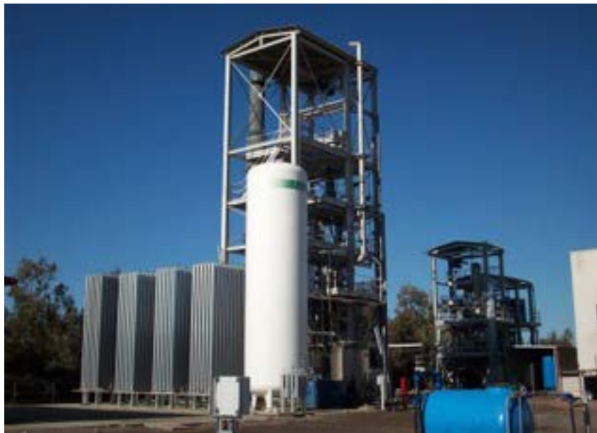
Figura 1.1. La piattaforma pilota Sotacarbo.
