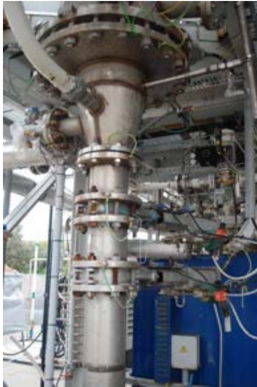
Figura 2.2. Condotto di adduzione degli agenti gassificanti e ghigliottine per lo scarico delle ceneri.
