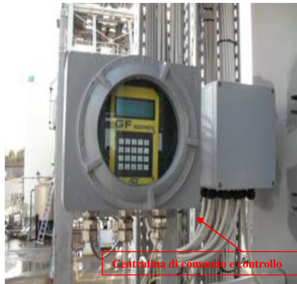
Figura 7 . Centralina di comando e controllo del misuratore di portata syngas
