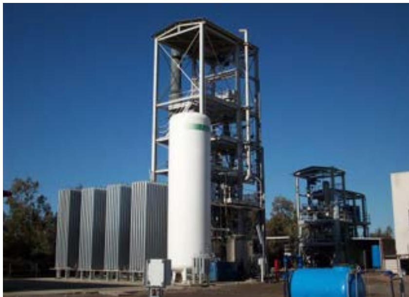
Figura 1 . La piattaforma pilota Sotacarbo.
