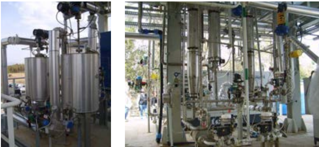
Fig. 15– Impianto Laboratorio: dettaglio delle sezioni di desolforazione a caldo e CO shift
