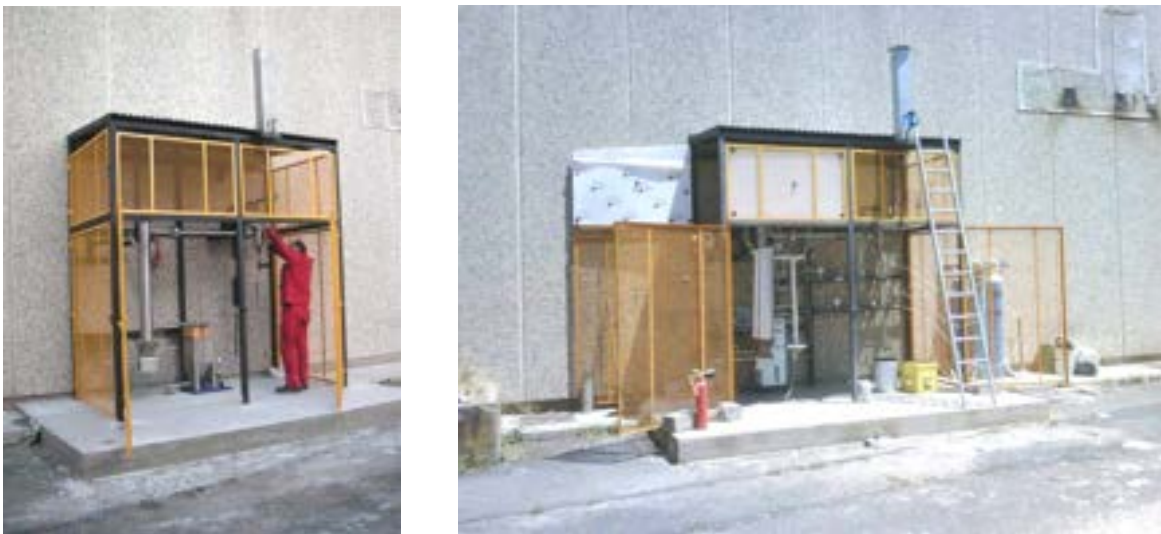
Fig. 1 – Impianto mini gassificatore GESSYCA presso il C.R. ENEA Casaccia
