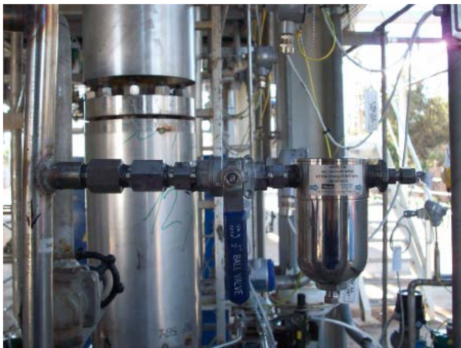
Presa di campionamento del syngas con sistema di condizionamento
