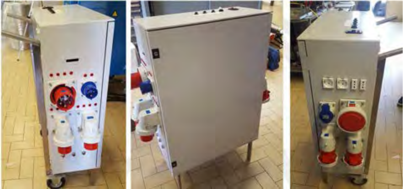
Figura 1: al centro quadro mobile realizzato in collaborazione con Univ. TorVergata; a sin e a destra rispettivamente le sezioni di ingresso e uscita dei collegamenti di potenza
