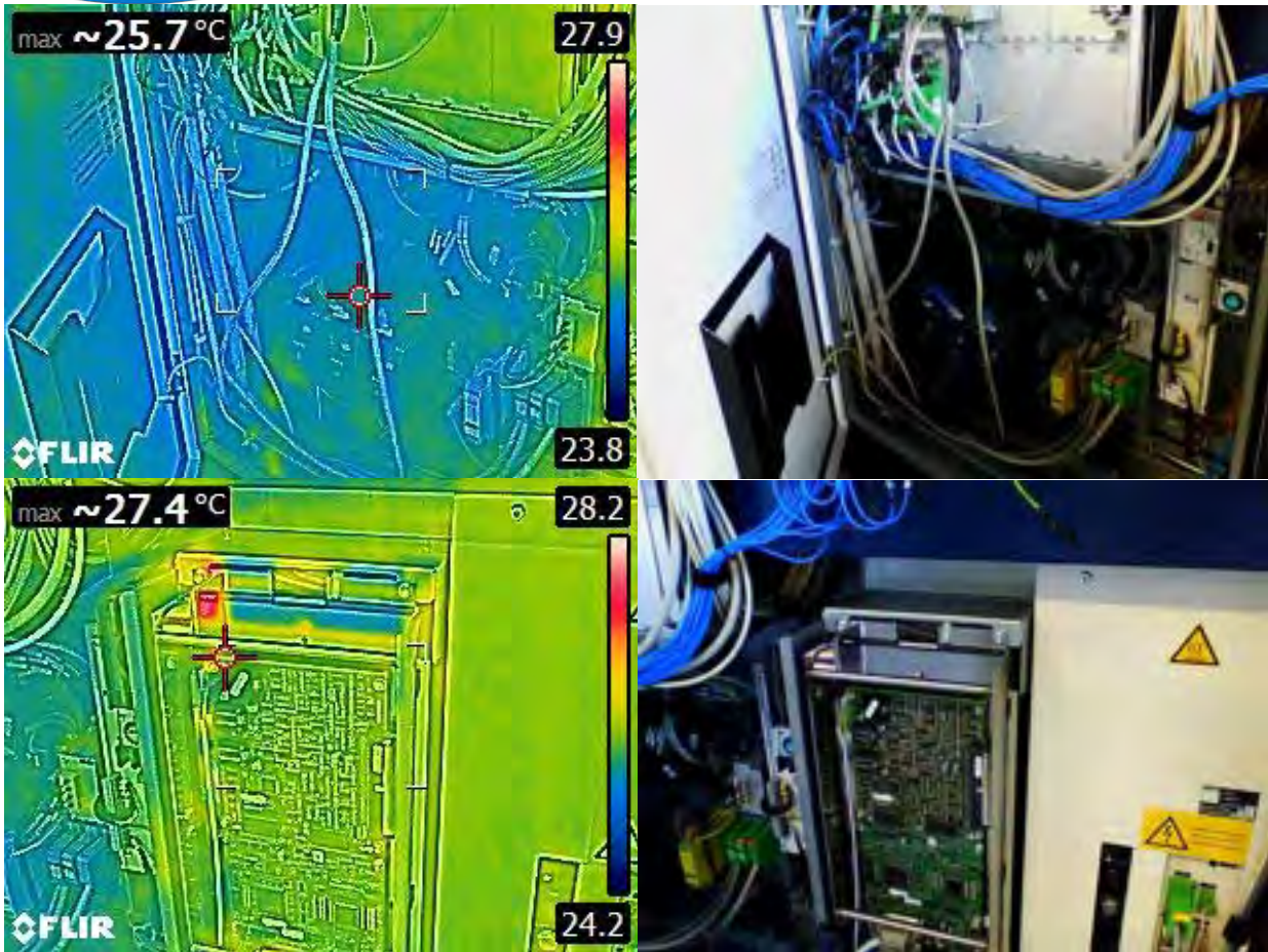
Figura 35: Monitoraggio degli armadi elettrici di potenza del laser TRUMPF prima dell'emissione
