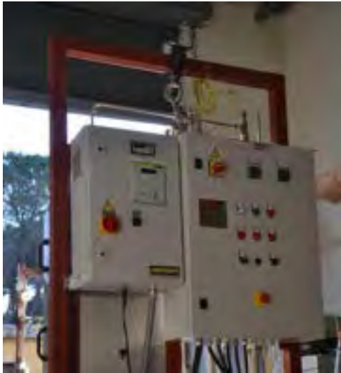
Figura 10. a) Quadro di controllo dell'impianto
