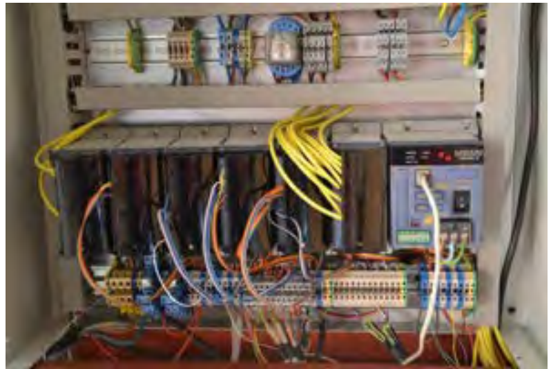
Figura 10. b) Dettaglio del quadro di controllo dell'impianto
